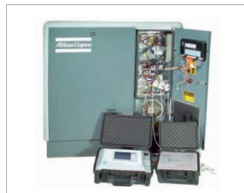
Beispiel: Messung am Kompressor
